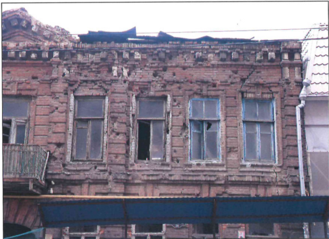
4 Следы от обстрелов в годы Великой Отечественной войны в восточной части главного фасада в уровне второго этажа. Фото 2023 г.
